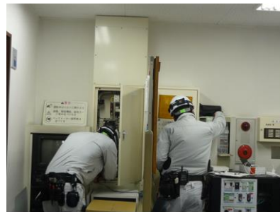
警報装置の点検及び動作確認をして頂いています。
