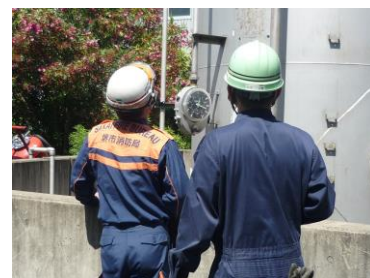
灯油タンクの計器類等の点検をしています。
