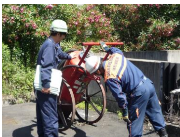
灯油タンク脇に設置している大型消火器の点検中。
